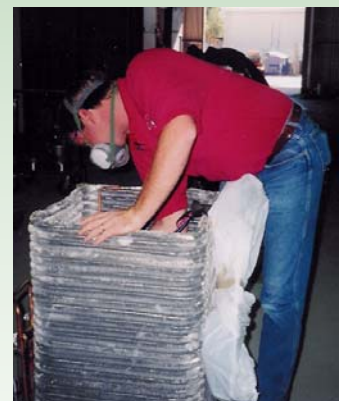
Contratista aplicando Sea Coast Protector en un serpentín de aletas de cepillo
