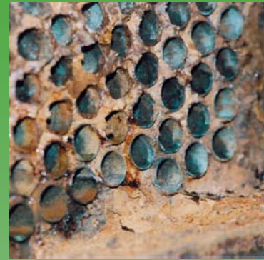
Antes del Tratamiento
